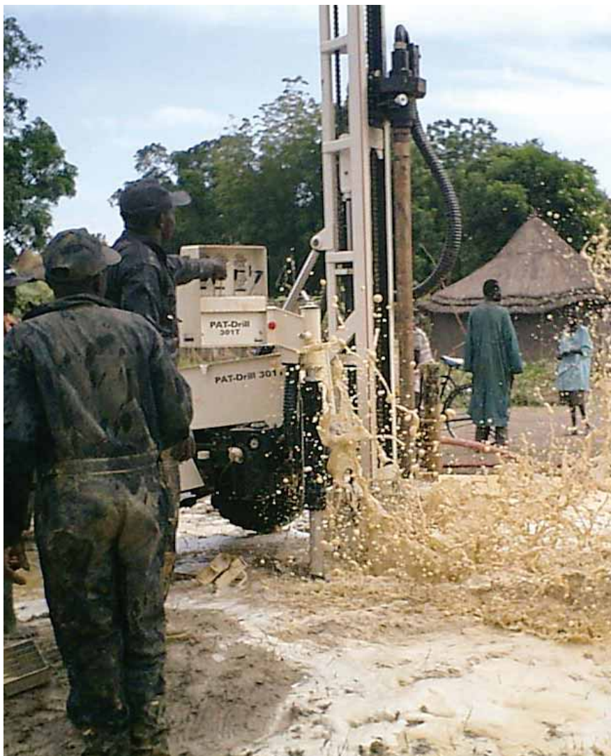
Uma sonda portátil atravessando um lençol de água
