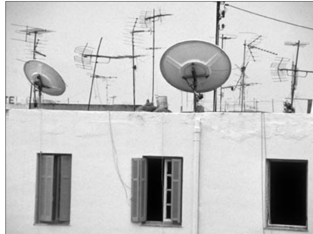
An antenna forest in Sousse (Tunisia)
