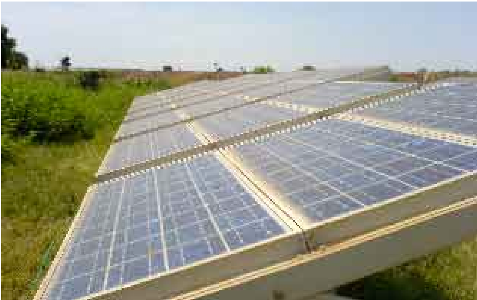
Panneaux de pompe solaire de Segala, Mali
