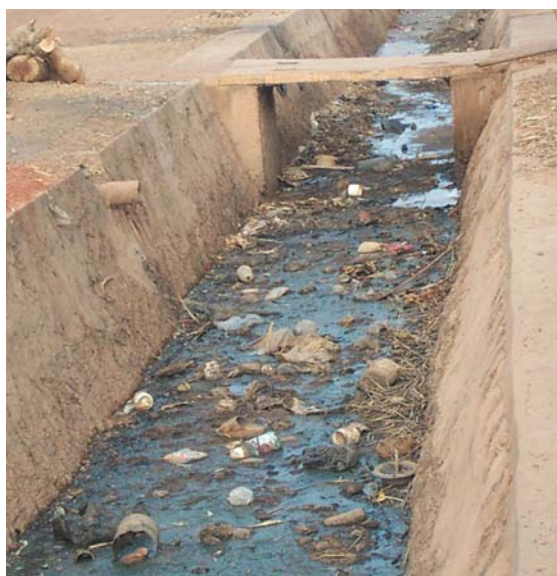
Les caniveaux sont souvent utilisés comme dépotoirs plutôt que conduit des eaux de ruissellement
